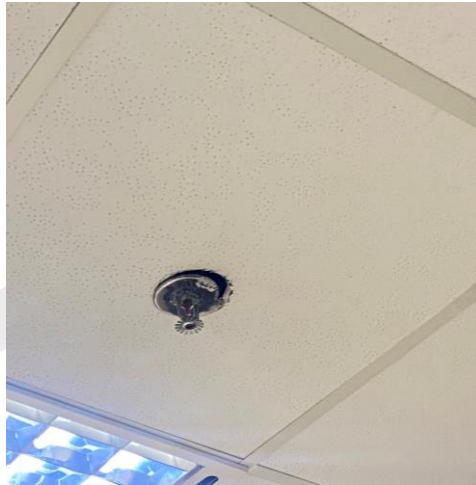
Foto 4.29 Water Sprinkler (Kanan)
