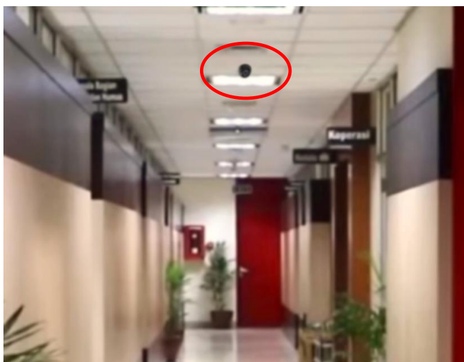
Foto 4.26 Kamera Pengawas (CCTV) di Lorong
