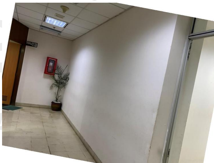
Foto 4.28 Alat Pemadam Kebakaran Ringan (APAR)
