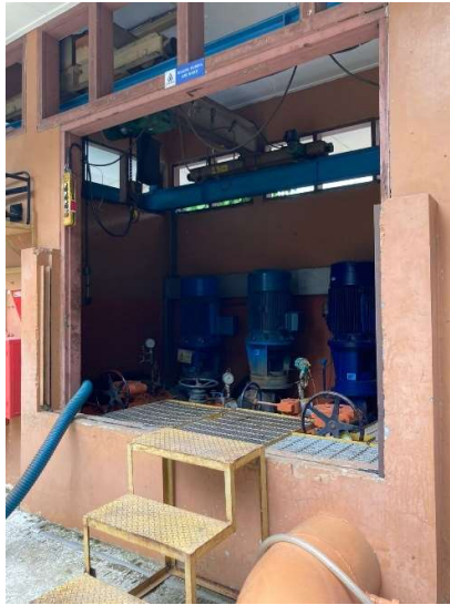
Gambar 4.4 Rekayasa Teknik pada Ruang Pompa Intake IPA Cilandak Sumber: Penulis, 2024
