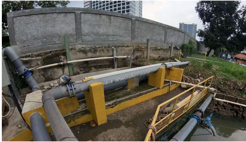
Gambar 4.6 Pipa Pengendali Banjir IPA Cilandak
